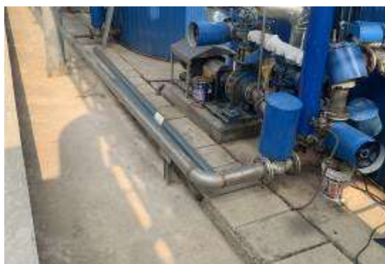
黑液周转罐区废水收集沟
