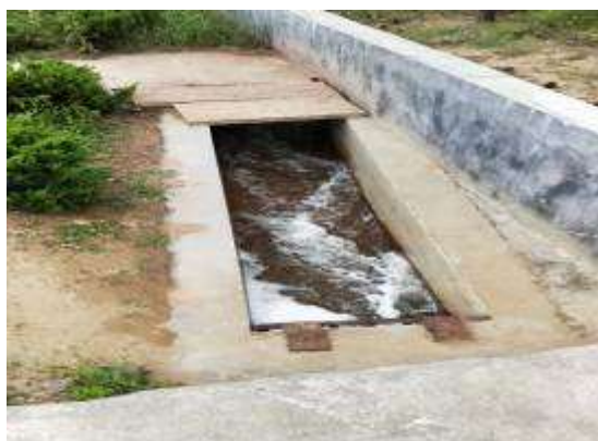
污水总排放口
