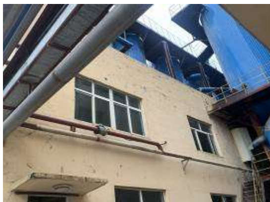
苛化车间（现有工程）
