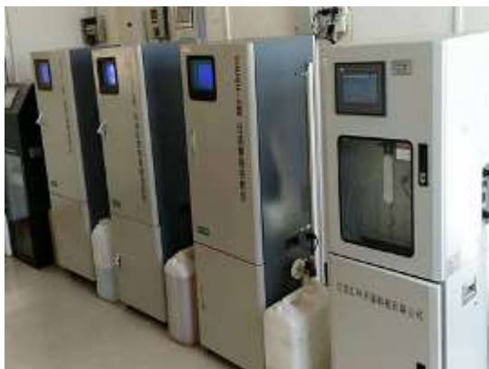
废水在线监测设施
