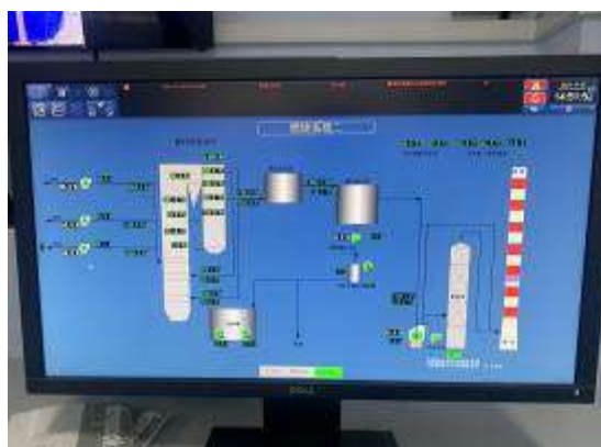
废气治理设施全自动化 PLC 控制
