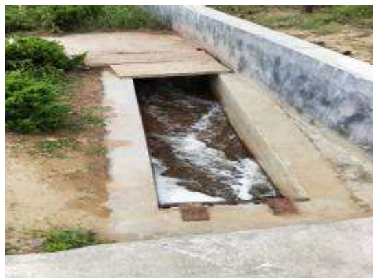
废水总排放口
