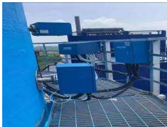
废气在线监测设施
