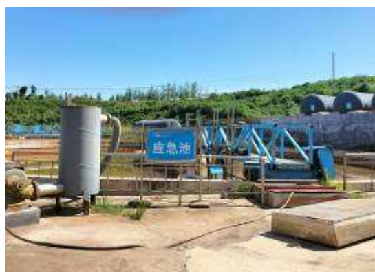
现有事故水池
