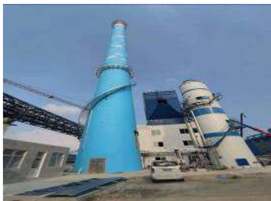
废气采样监测平台
