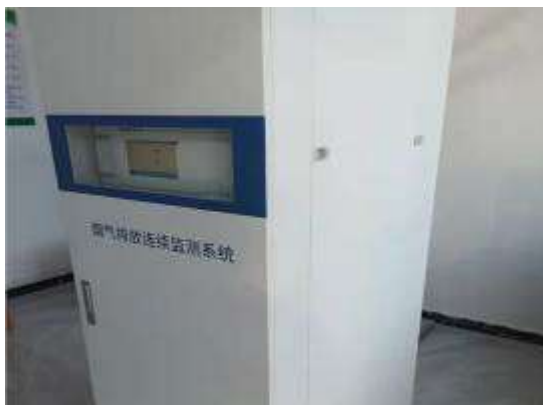
废气在线监测设施
