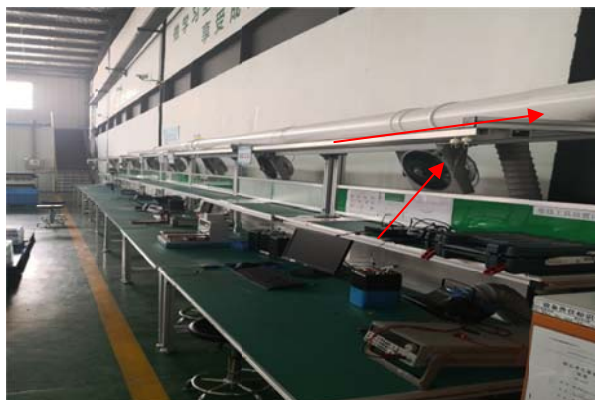
手动锂电池组生产线废气收集系统
