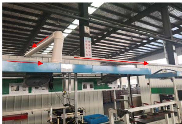
废气收集管道
