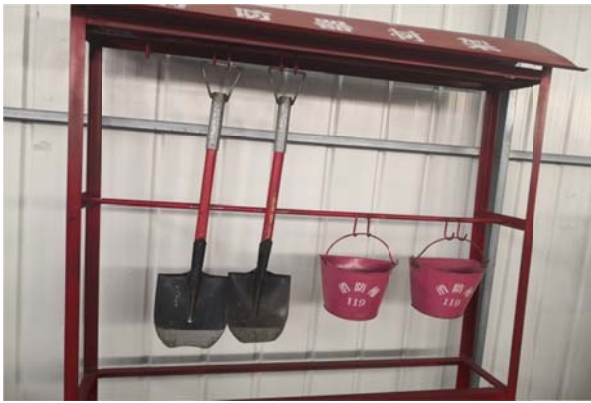
生产车间消防器材
