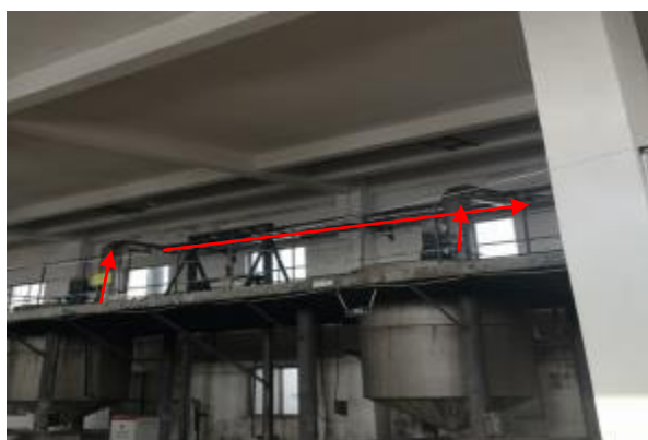
反应釜废气收集管道
