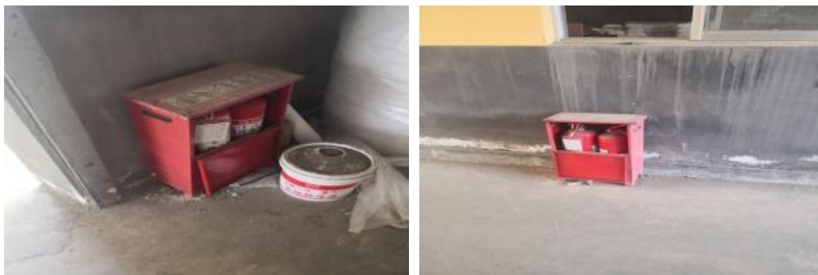
生产车间灭火器
