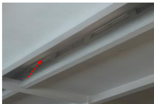
生产车间换气设施
