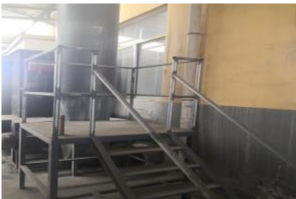
15m 排气筒及监测平台
