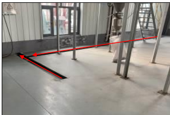
车间废水收集沟
