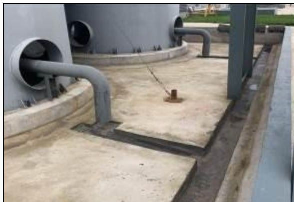
车间废水收集沟
