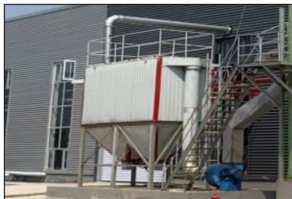
造粒工序废气布袋除尘器
