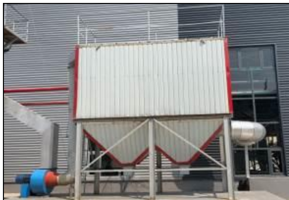
烘干、破碎、冷却等工序废气布袋除尘器
