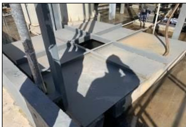
车间废水收集池
