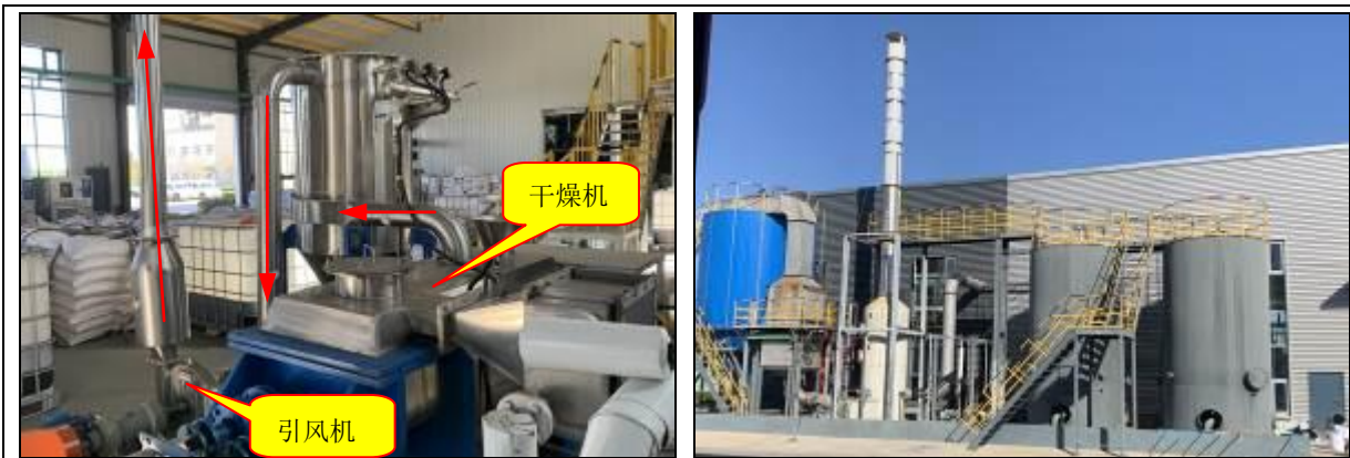
桨叶干燥粉尘布袋除尘器
