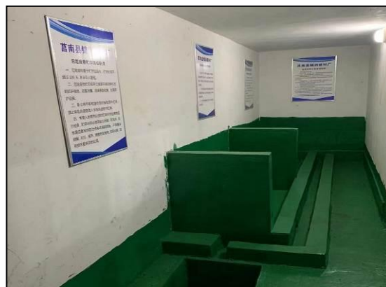
分区隔段、导流沟集水槽
