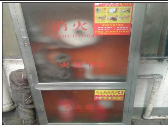
室内消火栓、灭火器
