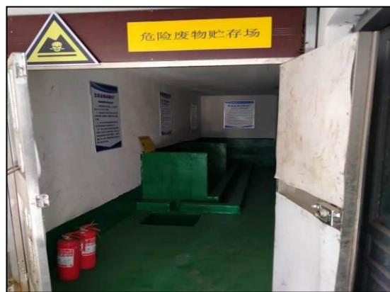
危废库内设置灭火器
