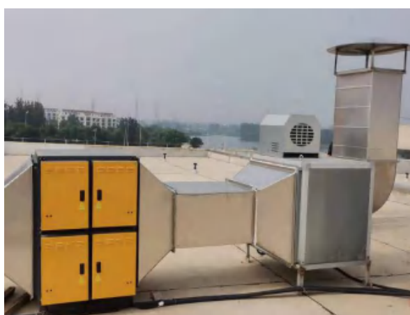
幼儿园食堂油烟净化器+排气筒
