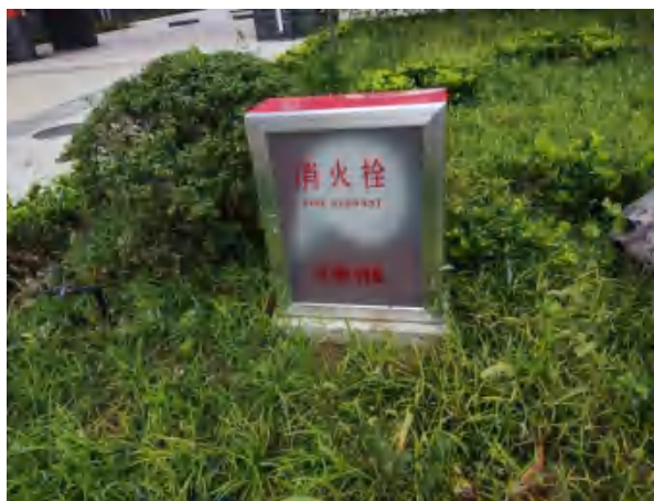
学校内消火栓
