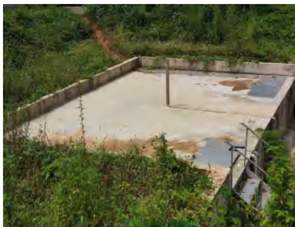
废水进市政管网处
