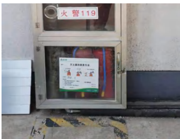
危废库灭火器
