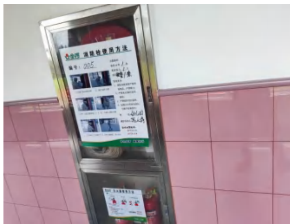
教学楼消火栓
