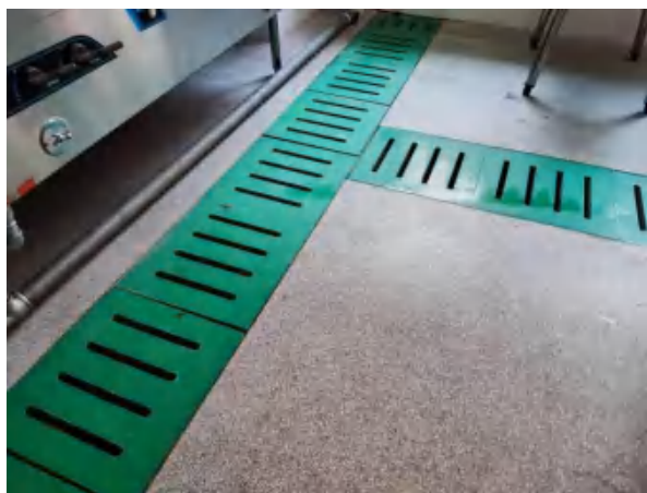
食堂废水管道
