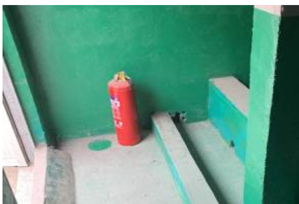
危废库灭火器
