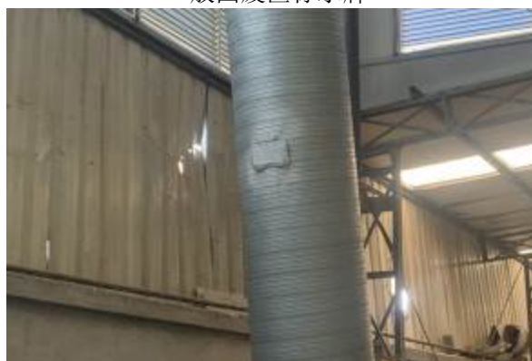
废气处理前取样口
