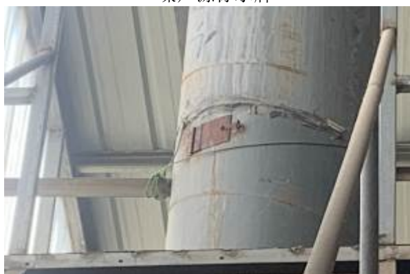
废气处理后取样口
