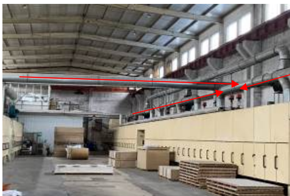
废气收集管道
