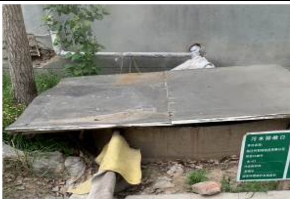
蒸汽冷凝水水箱
