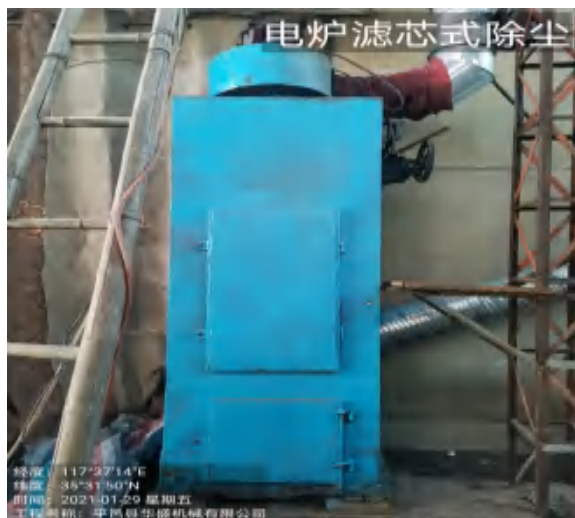
电炉熔炼废气处理设施
