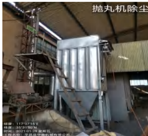
抛丸工序废气处理设施
